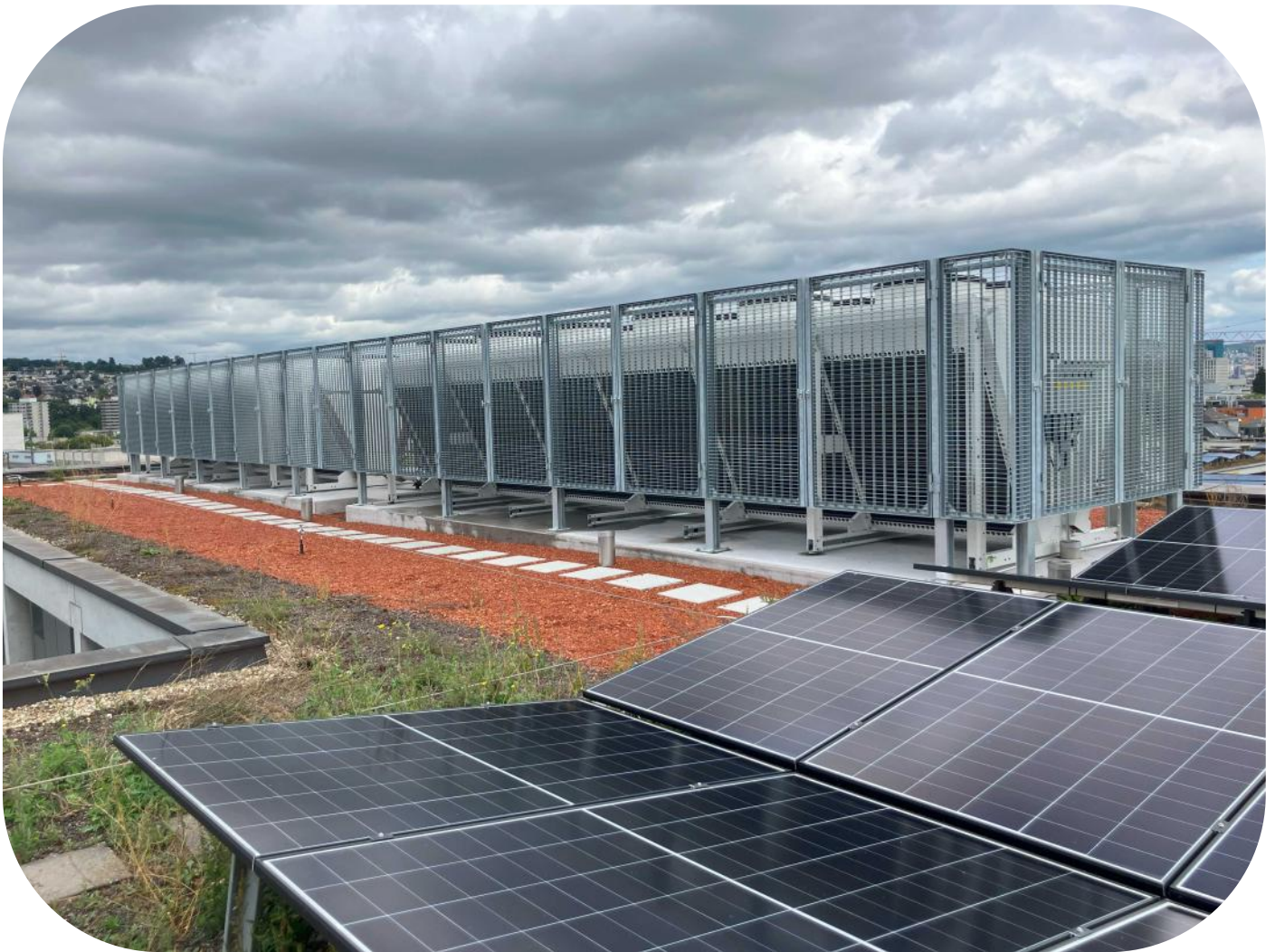
Rückkühler und Photovoltaik auf dem Dach „Im Stückler“
